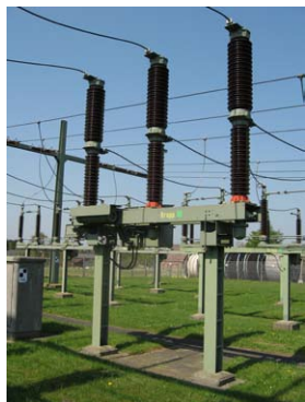
Foto des Leistungsschalters
